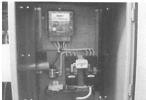
図12 耐雷トランスを使用した分電盤
